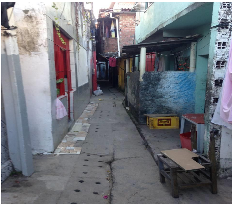
Figura 27 – Galeria pluvial usada para escoamento de esgoto na ZEIS Coelhos
