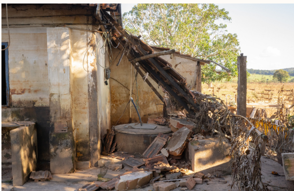
Figura 2 - Cisterna submersa pelas águas do rio Paraopeba durante as cheias de 2022. Destaque para as marcas do rejeito na parede da residência. Foto: Thaíssa Oliveira
