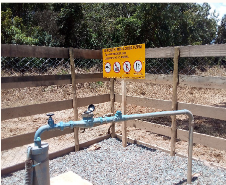
Figura 2 - Poço artesiano perfurado atingido pelas cheias em 2022. Destaque para as marcas de lama no cercamento (linha tracejada). Foto: Thaíssa Oliveira
