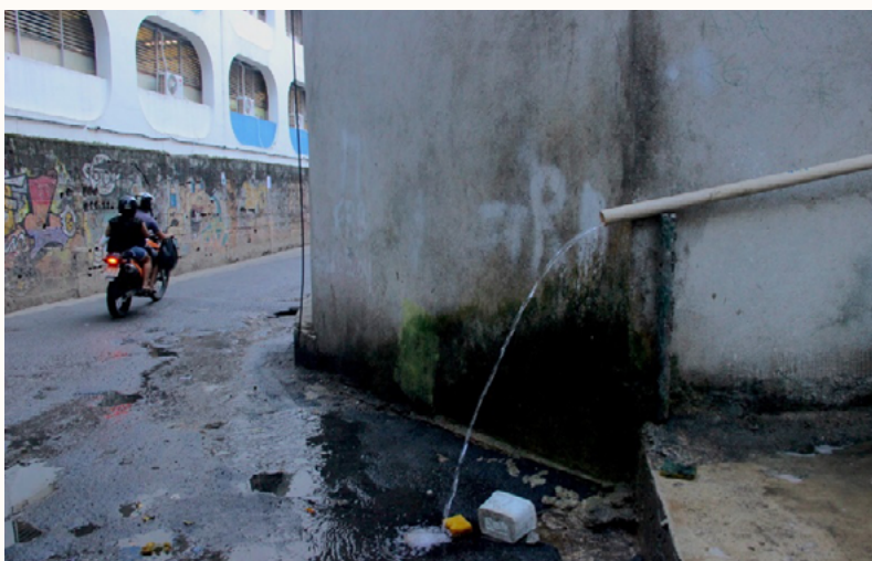
Figura 3 – Esgoto correndo a céu aberto nas vielas da Rocinha. Foto: Michel Silva
