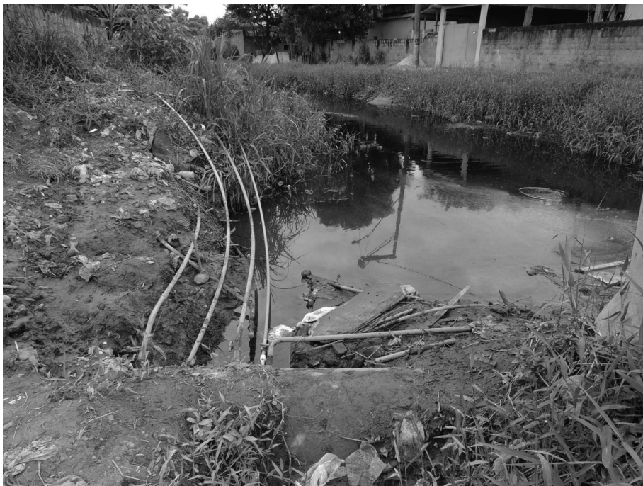
Foto 1: Ligações irregulares na adutora da Petrobras.
